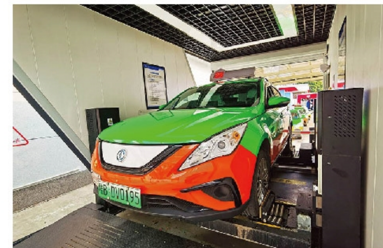
● 正在换电的新能源出租车
