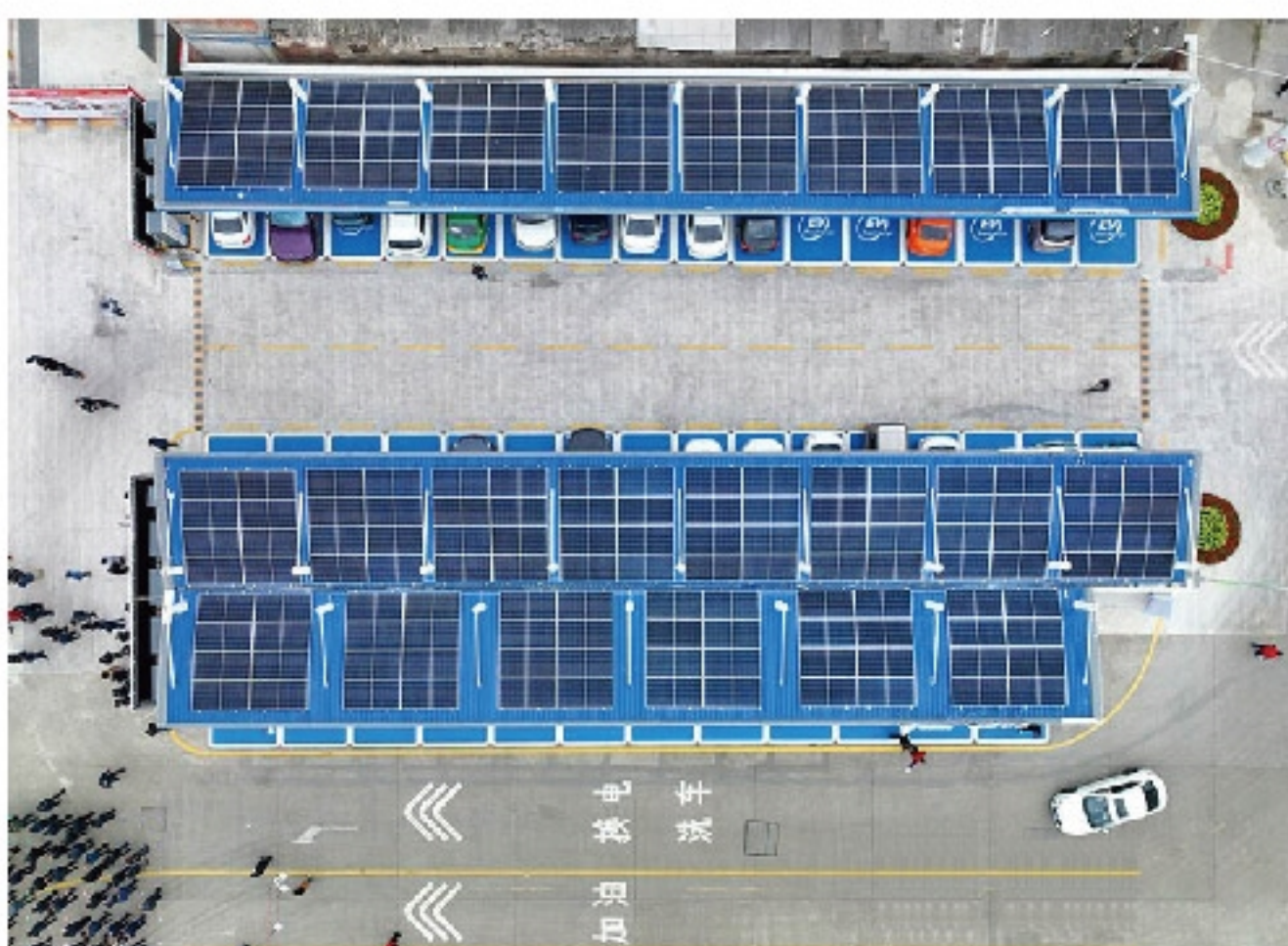
● “易捷+电”综合服务站充电区配套建设的光伏发电板
